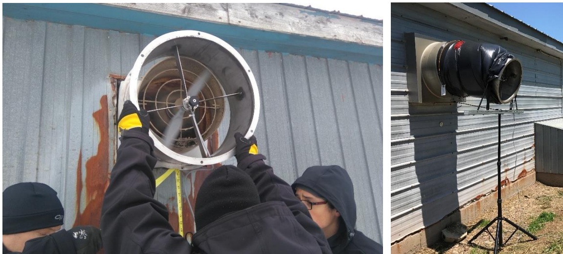
Figure 21 Installation du débitmètre à hélice
