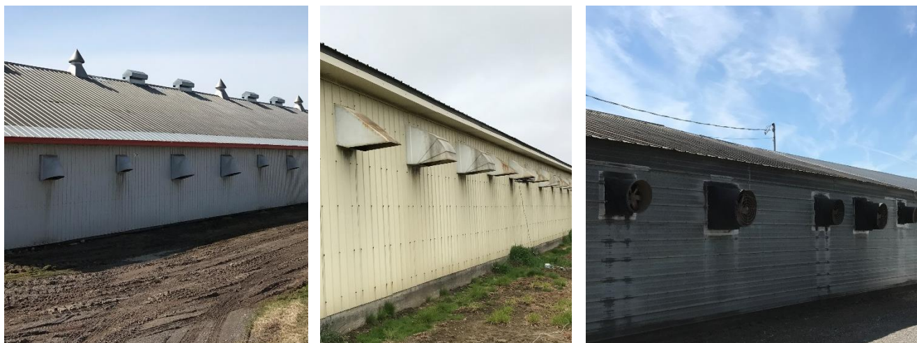
Figure 20 Reconnaissance du lieu et des différents types de ventilateurs rencontrés
