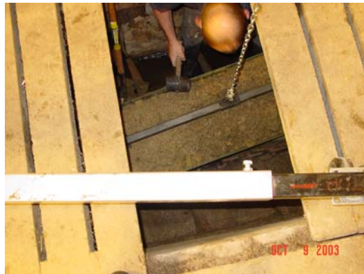
Figure 18 : Vue de la procédure de levage et pesée du réservoir de collecte des solides
