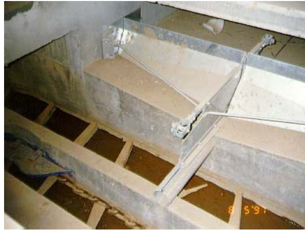
Figure 9 : Vue de la décharge du dalot en « V » vers l'écureur à chaîne
