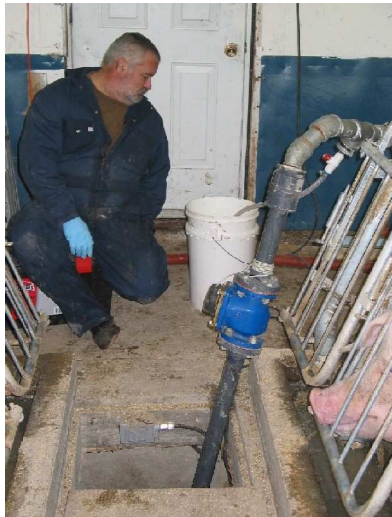
Figure 9 : Vue de la procédure de pompage et de collecte de la fraction liquide
