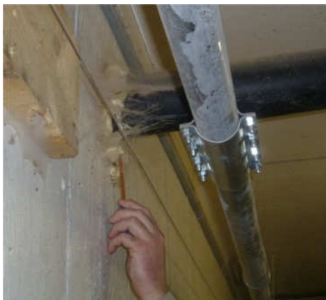
Figure 28 Test de fumée effectué sur le pourtour d'une conduite d'alimentation en moulée étanchée avec de la mousse permettant de voir qu'une infiltration d'air est possible
