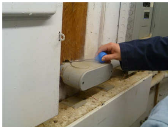
Figure 27 Infiltration d'air par l'orifice du mur créé par un boîtier de raccord en PVC devant être colmaté avec du scellant approprié
