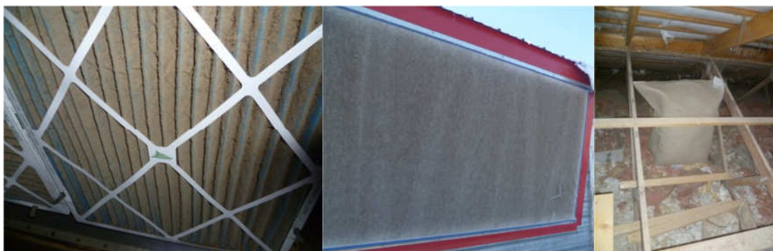
Figure 14 Préfiltres poussiéreux devant être remplacés
