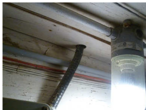
Figure 26 Pourtour de fil électrique permettant une infiltration d'air devant être colmaté de façon appropriée
