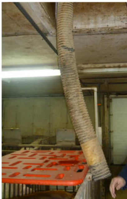
Figure 50 Une infiltration d'air est possible par la chute de moulée d'un silo vide
