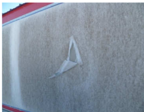
Figure 13 Préfiltre endommagé devant être remplacé
