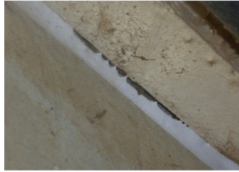
Figure 22 Scellant appliqué à la jonction mur-plafond ayant décollé de la surface et devant être retiré et appliqué de nouveau
