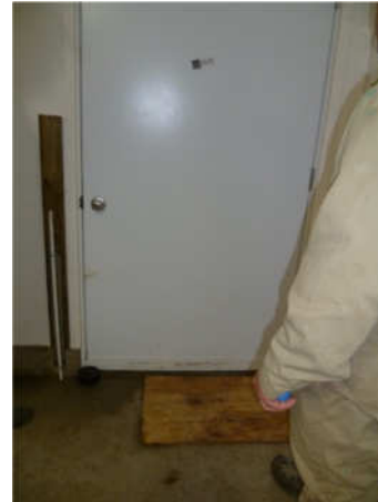
Figure 33 Seuil de porte surélevé par rapport au plancher protégé par un seuil temporaire en bois
