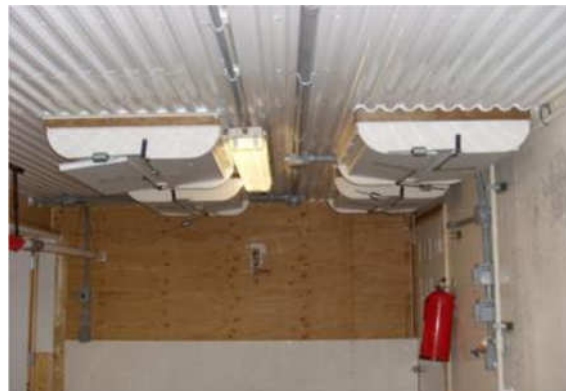
Figure 35 Entrées d'air à contrepoids permettant l'entrée d'air filtré à l'intérieur d'un quai ventilé sous pression négative
