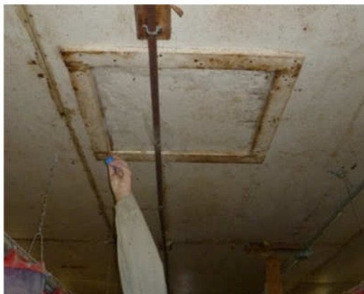
Figure 48 Trappes d'accès vers l'entretoit ayant été condamnées
