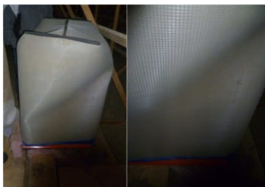
Figure 15 Filtres antimicrobiens encrassés de poussière devant être nettoyés
