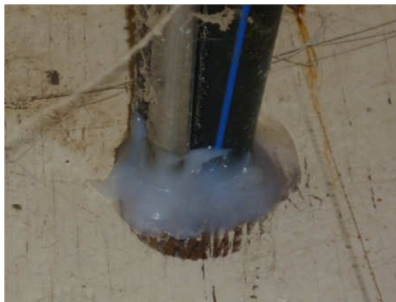
Figure 29 Pourtour de conduite d'alimentation en moulée étanchée de façon à éviter l'entrée d'air parasite. Préconiser toutefois l'installation de collet en caoutchouc flexible
