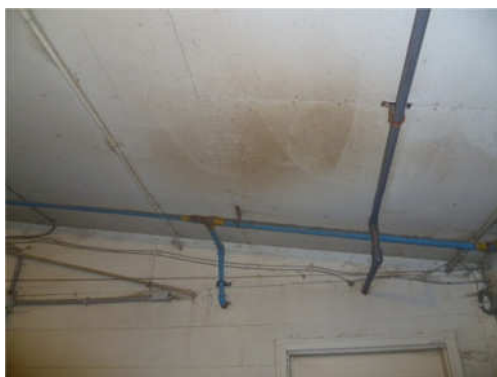
Figure 25 Le pourtour de ces conduites de propane doit être calfeutré avec un scellant approprié (Flextra)
