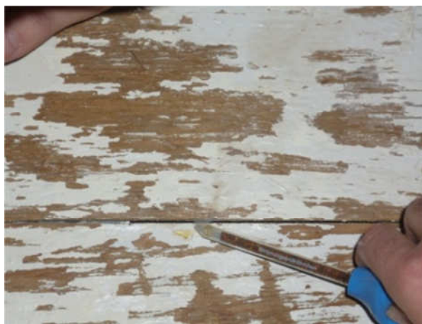
Figure 20 Joint entre deux feuilles de contreplaqué devant être colmaté
