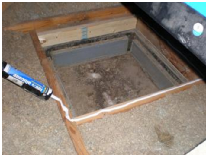
Figure 11 Il est très important de s'assurer d'avoir des caissons de filtration installés de façon étanche lors de la mise en place, car après l'installation, il est difficile de constater les fuites.
