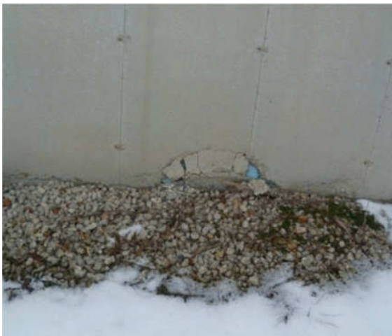
Figure 23 Bris dans le béton d'un mur sandwich
