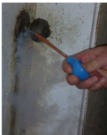
Figure 17 Test de fumée démontrant une infiltration d'air par les trous de vis d'une poignée de porte extérieure
