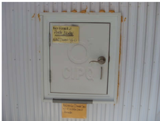
Figure 7 Porte étanche permettant de mettre la semence dans le réfrigérateur de la ferme
