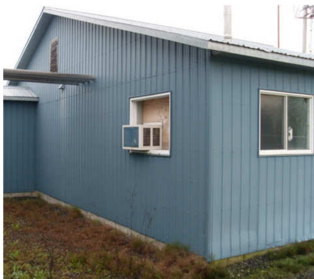
Figure 47 L'air utilisé par le système d'air conditionné ne doit pas provenir de l'extérieur (non filtré). Le système doit obligatoirement recirculer l'air intérieur
