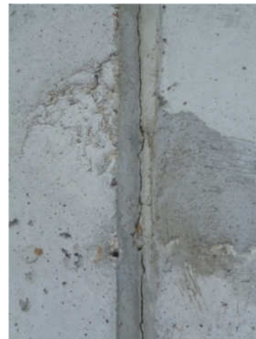
Figure 24 Mur sandwich dont le joint de contrôle ayant fissuré doit être colmaté avec un scellant approprié
