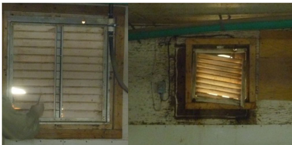
Figure 37 Cadres à volets endommagés devant être remplacés
