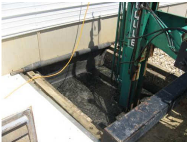
Figure 46 Toile descendant sur le lisier permettant de minimiser l'infiltration d'air Photo : Darwin Reicks
