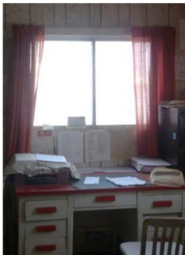
Figure 18 Fenêtre de bureau devant être étanchée et couverte d'un plexiglass par l'intérieur
